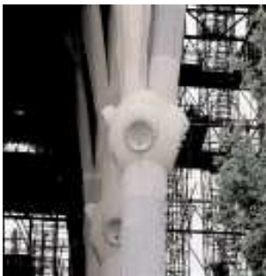
Maclación de elipsoides en los nudos de las columnas de la nave del templo de la Sagrada Família
