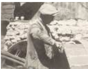
La habilidad del albañil es fundamental para la construcción de una bóveda tabicada (fig. 3)
