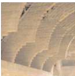
Demostración de las extraordinarias posibilidades de la obra de fábrica de ladrillo de la torre de Bellesguard (fig. 15)
