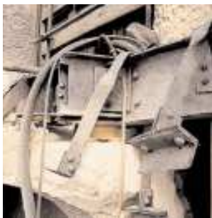
Anclajes de acero fijados a la estructura del edificio para sostener los sillares de la fachada (fig. 8)
